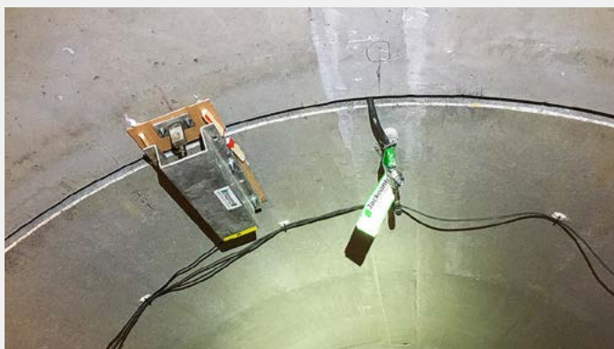
MITTELS LEIM BEFESTIGTER WEGMESSESENSOR IM FIRST
