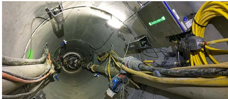
MT.CONNECT-MSS-BOX IM STOLLEN INSTALLIERT
