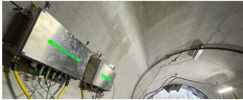
MT.CONNECT BRINGT DAS INTERNET IN DEN TUNNEL
