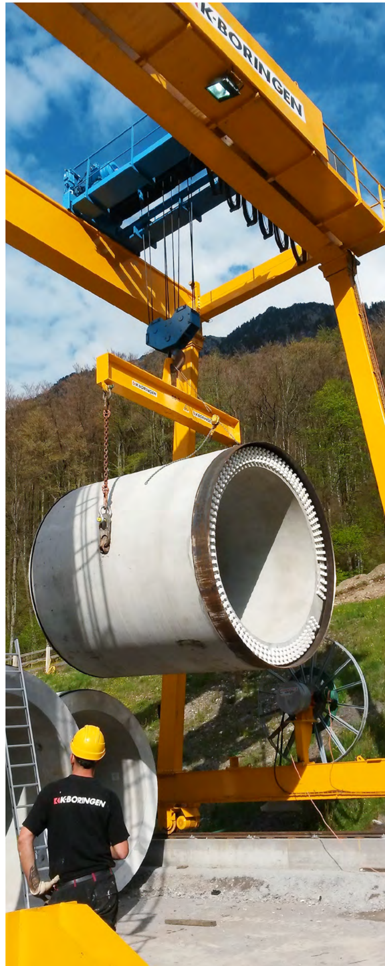
VORTRIEB KRAFTWERK DOPPELPOWER, SCHWANDEN (CH): ROHRHUB
